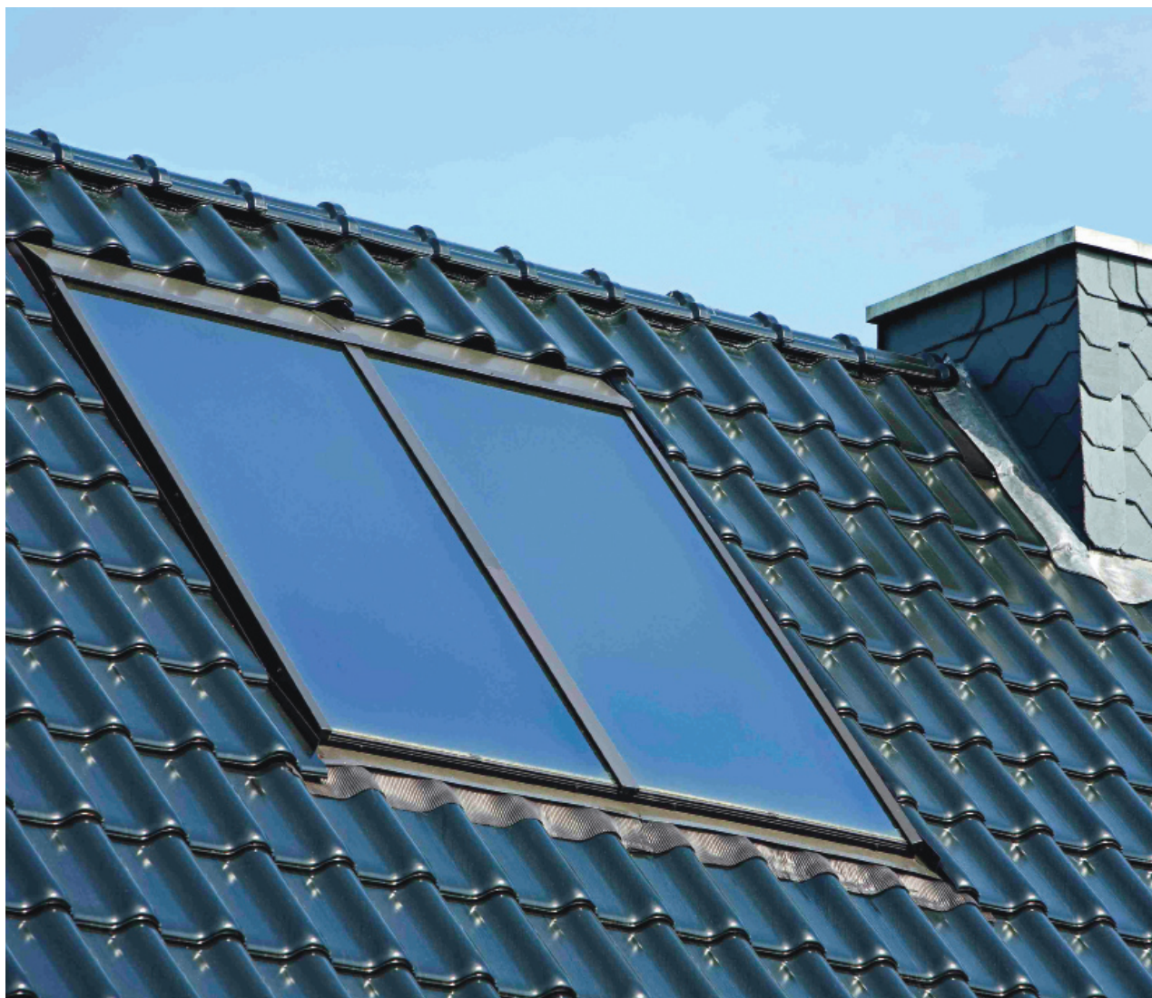
Dom mieszkalny – instalacja solarna 4,24 m 2 do podgrzewania wody użytkowej
