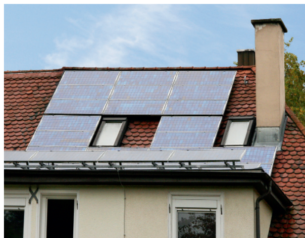
System nadachowy - przykład nieestetycznego montażu
